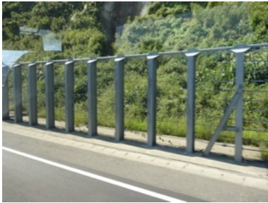
道路の路肩にも低い雪崩防止柵が設置
